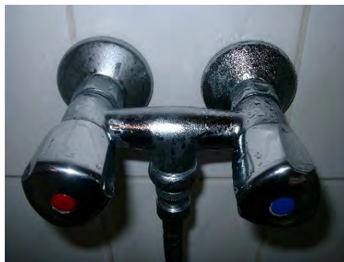
Obr. 1.10 Podstatne viac orosený prívod studenej vody ako teplej na vodovodnej batérii v kúpeľni
